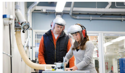
Oppilaitosten purun- ja tekstiilipölynpoistot
