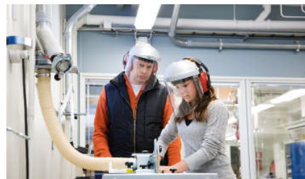
Oppilaitosten purun- ja tekstiilipölynpoistot
