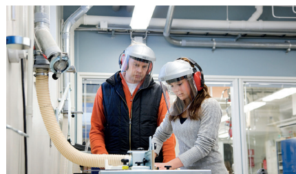
Oppilaitosten purun- ja tekstiilipölynpoistot
