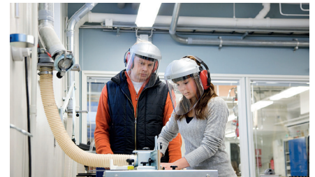
Oppilaitosten purun- ja tekstiilipölynpoistot
