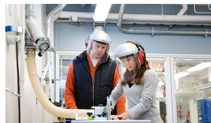
Oppilaitosten purun- ja tekstiilipölynpoistot
